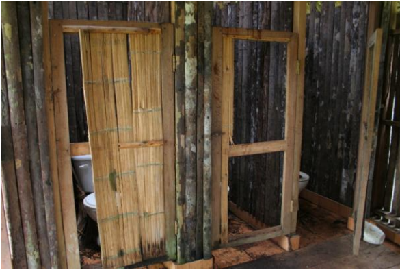
Abbildung 42 (links): beschädigte Konstruktion der Wasserspültoiletten
