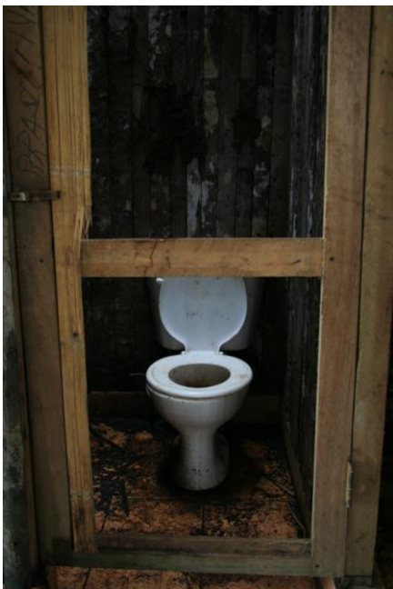
Abbildung 12: verschmutzte Wassertoilette der Schule mit kaputter Tür
